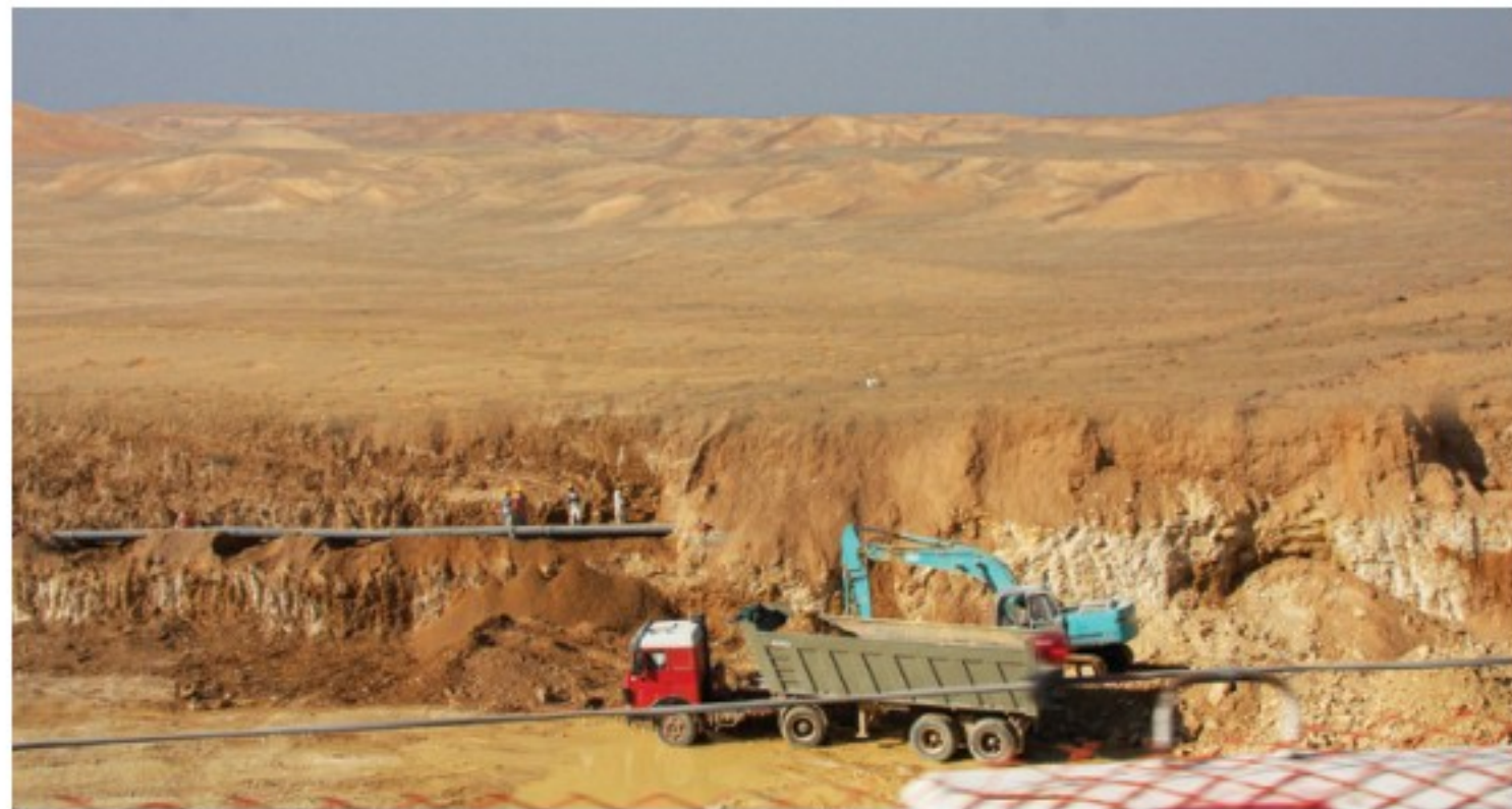
الشكل ٨ عملية الإنشاء تدمر أجزاء من البيئة. وتساعد قوانين الحماية في بعض الدول على تقليل كمية الدمار الذي تحدثه.
