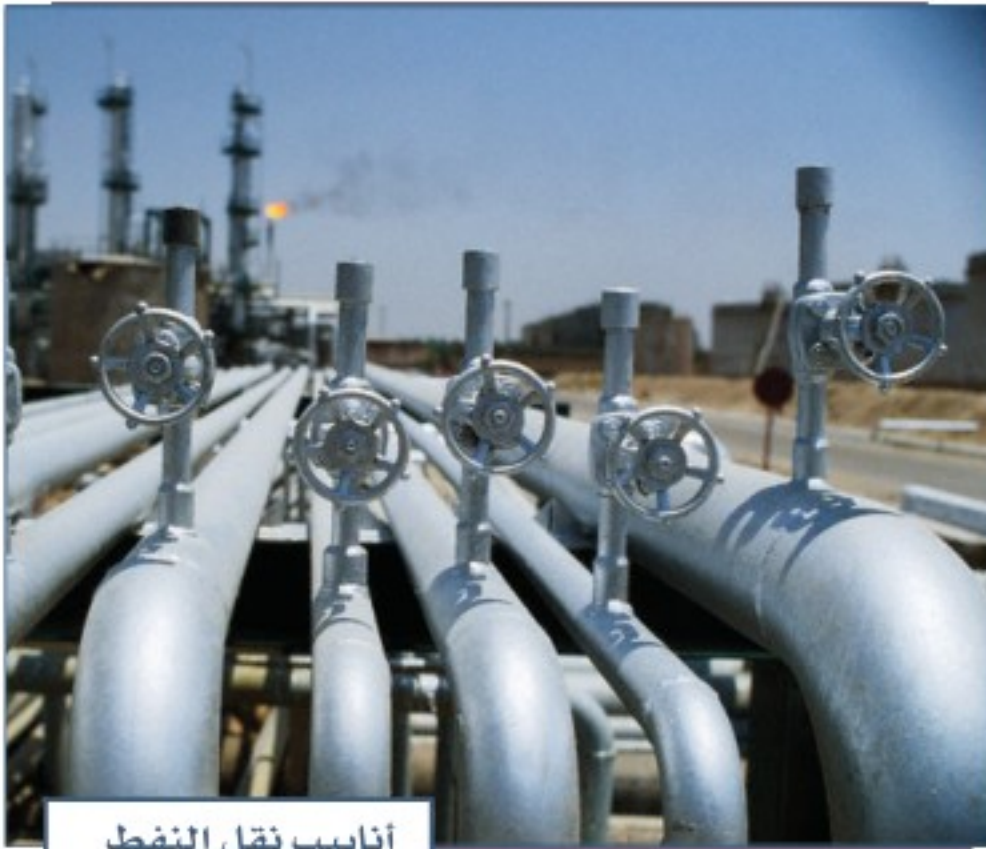
أنابيب نقل النفط
